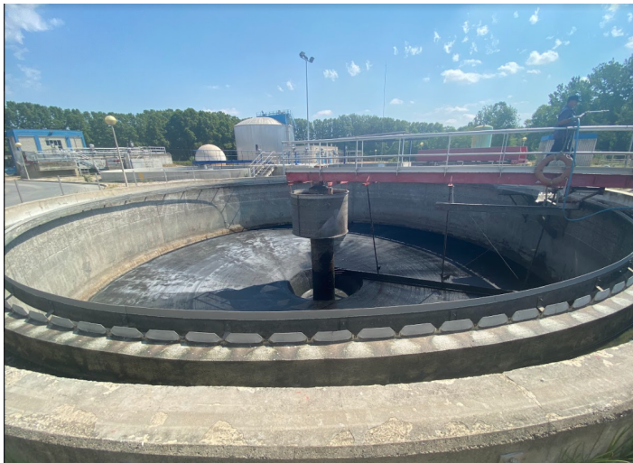
Figura 17: Decantador primari (Imatge pròpia).
