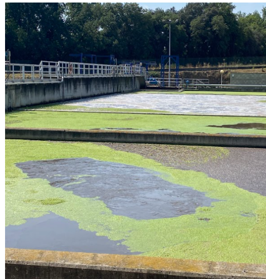
Figura 23: Decantadors (Imatge pròpia)
